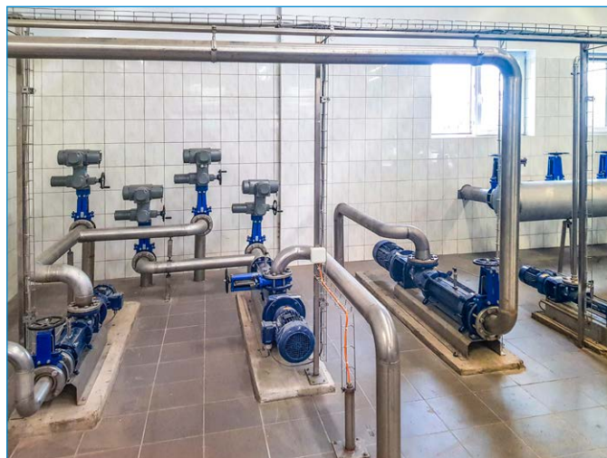
Fot. 1 Automatem sterowany węzeł rozdzielczy osadów – oczyszczalnia w Pelplinie, 2018 r.
