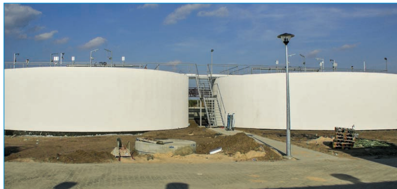
Fot. 5 | Reaktory BIOSELEKT
